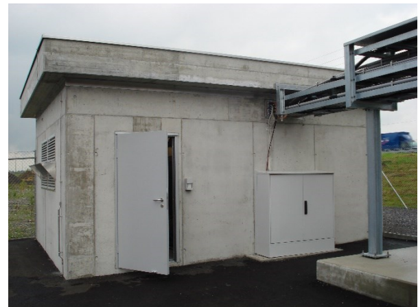
Techn. Raum (26m 2 ) mit Hohlboden und Freecooling
